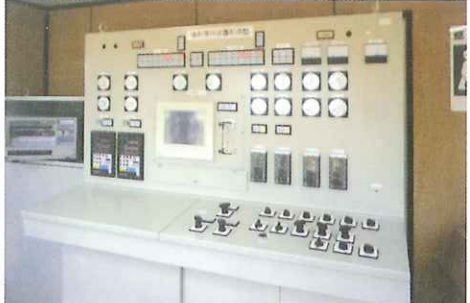
制御盤 Control panel
